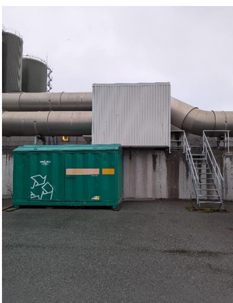
Figur 13: Miljøcontainer for farlig avfall
