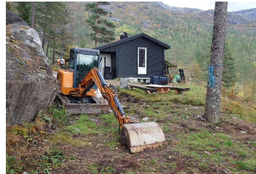
Gravemaskin med stor vekt og stålbelter har potensiale til å lage store skader i terrenget, spesielt i våte parti.
