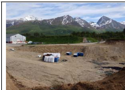
Tette containere for lagring av farlig avfall.
