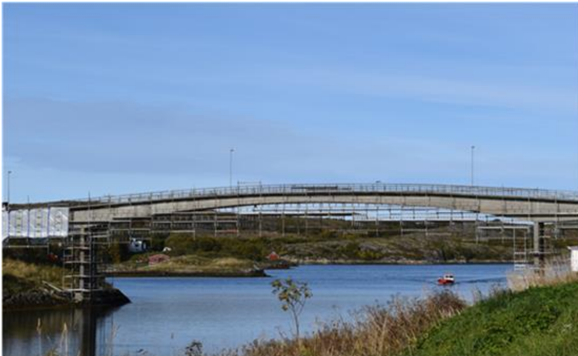
Gamle Herøysundet bru under vedlikehold sommeren 2020
