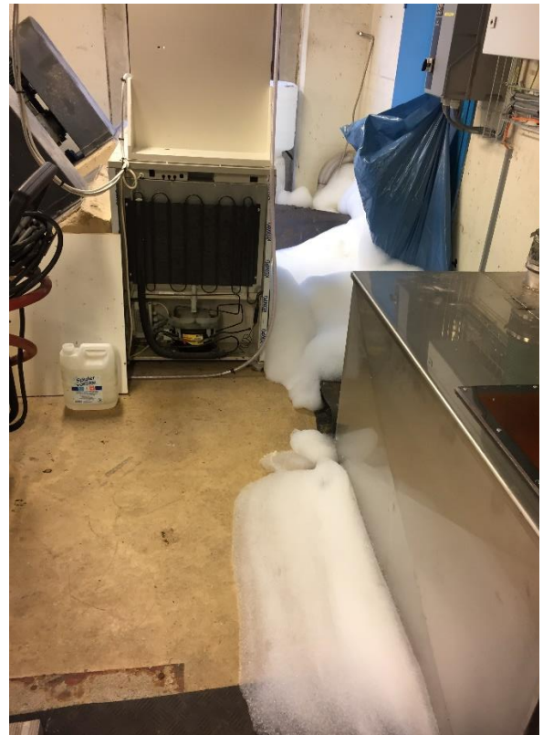
Figur 6: Store mengder såpe inn på anlegget.
