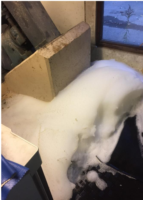
Figur 5: Store mengder såpe inn på anlegget.
