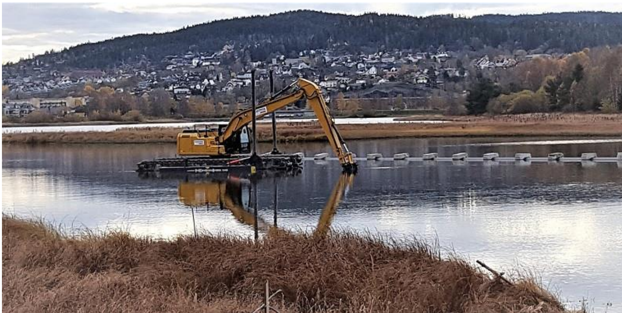
Figur 5.3 Fra etablering av Dy710 mm elveledning i Nitelva ved Nittedal, nedgraving utført med en amfibisk gravemaskin
