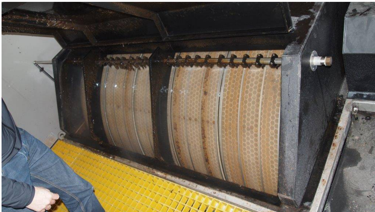
Bilde 5. Filtre som anvendes i resirkuleringsanlegget.
