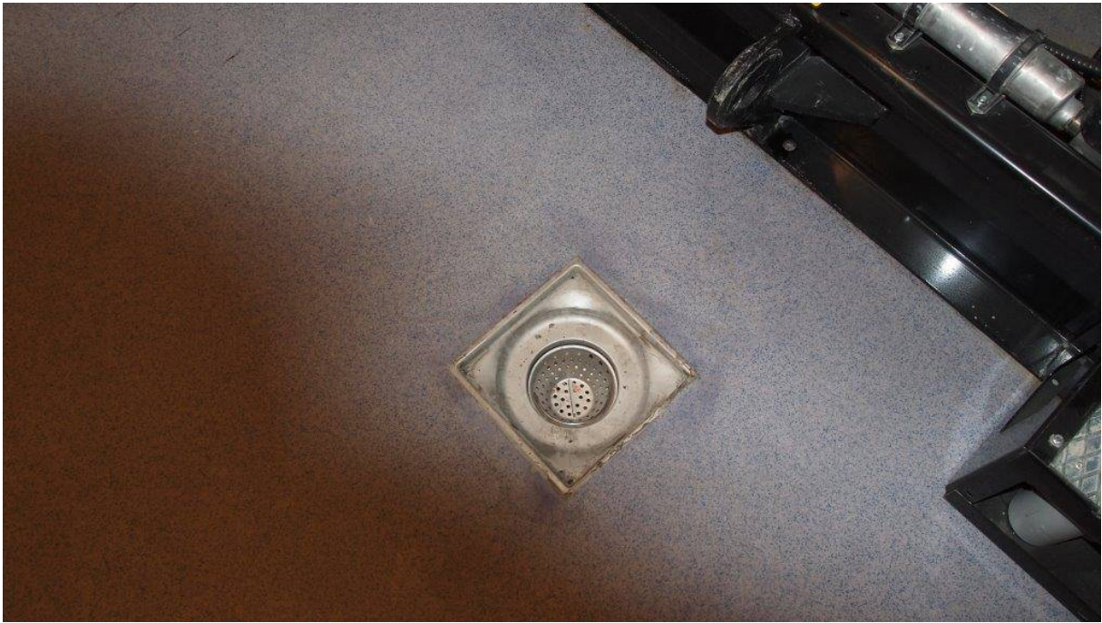
Bilde 2. Sluk i pumperom, leder til oljeavskiller (utilgjengelig på inspeksjon pga. arbeid med høyspentledninger på området).
