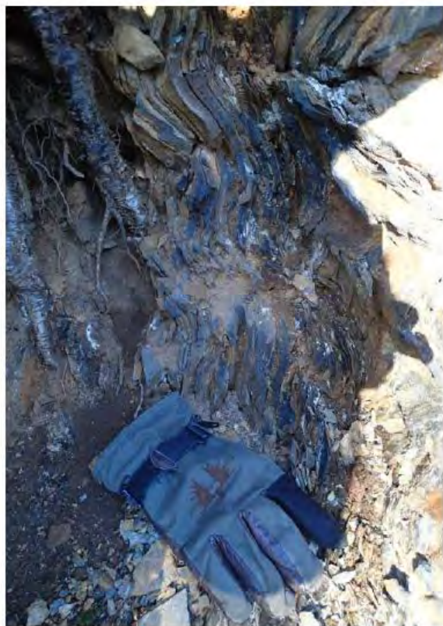
Figur 10 En sone med mørk skifer opptrer et par hundre meter nord for søndre påhugg ved Gausvik. Skiferlagene er tynne med en sprekkeavstand 1-5 cm. Koordinater: 33W 561329 7612256 UTM
