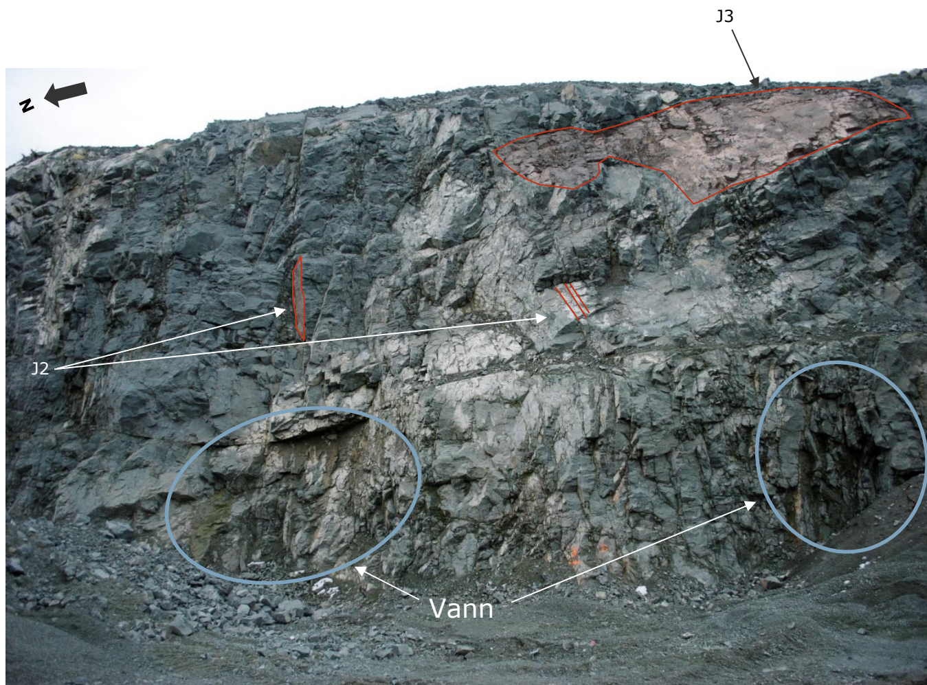
Figur 8: Bruddveggen mot sør. Foliasjon er markert med skravert område og faller skrått inn i bruddet. J2 står med strøklinjen nær vinkelrett på bruddveggen og faller mot vest, se markerte linjer. Det er observert noe vann fra sprekkeplan, se blå sirkler.
