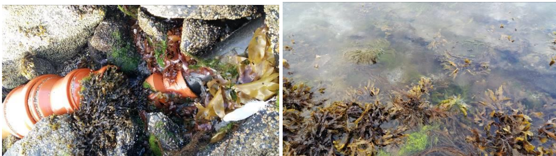
Figur 12. Til venstre: Brukken kloakkledning - nordre utlippsledning? Til høyre: Grumset vann ved søndre utslippsledning ved Stasjon L1. – Left: Broken sewage pipe north of the station? Right: Turbid water close to the southern surface water outlet pipe at Station L1.
