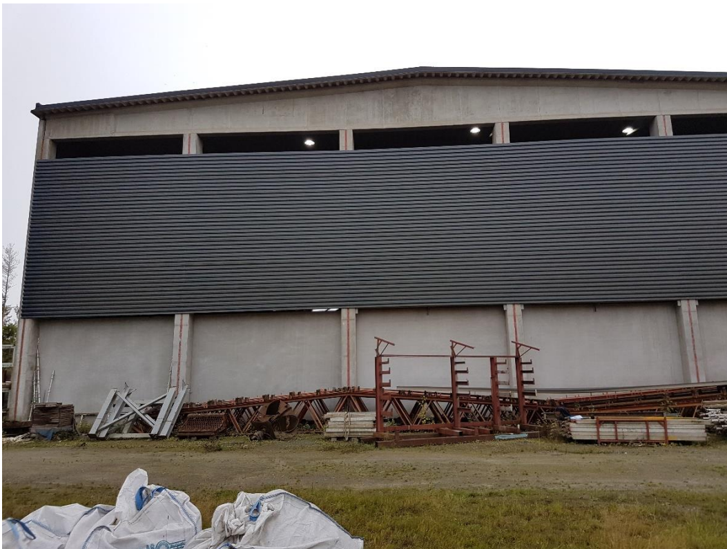
Figur B.4 Sikteverksbygning sett fra baksiden. Ventilsjønsgriller er lokalisert under the mørkegrå feltet.
