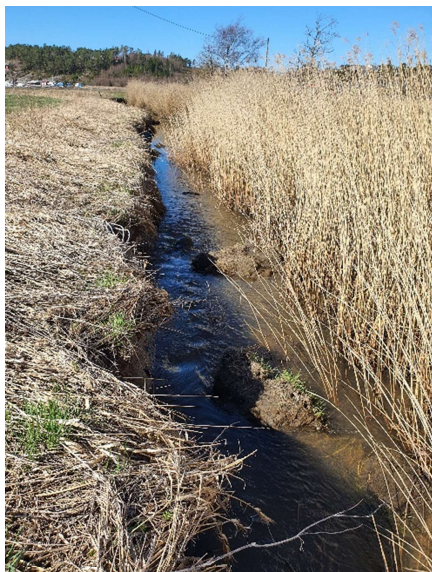
Svake kanter og erosjon fra Husebybekken
