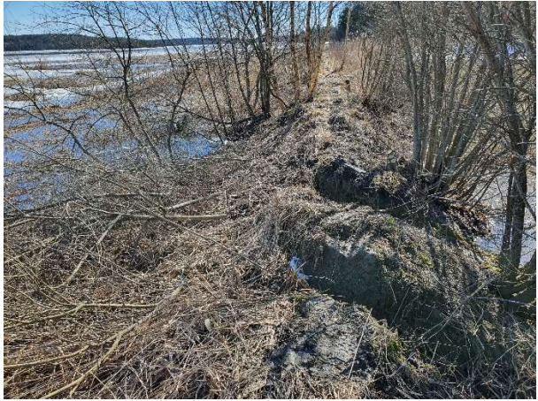
Skader på demning, må repareres fortløpende.
