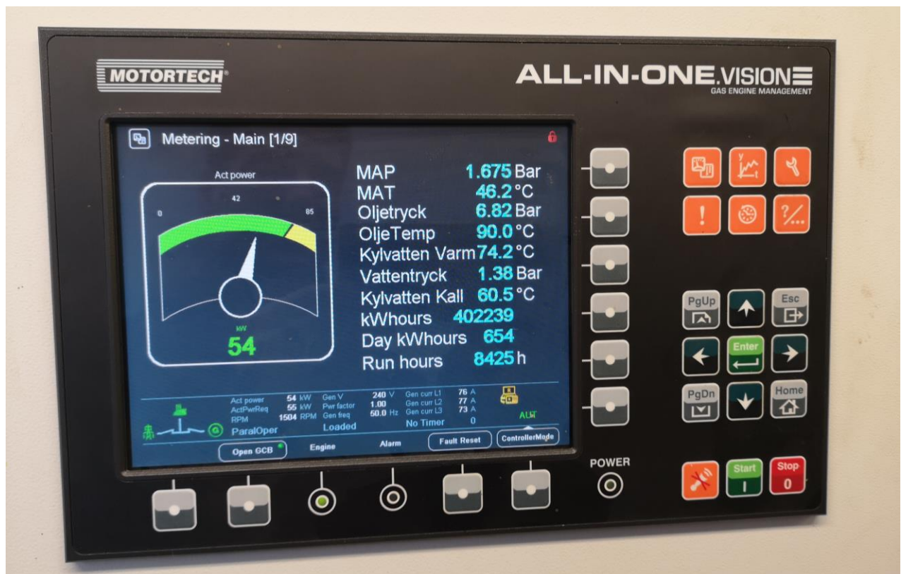
Figur 12. Styringspanelet i kontrollrommet til Gunvor og Kjell Kopperud. Foto: Statsforvalteren.
