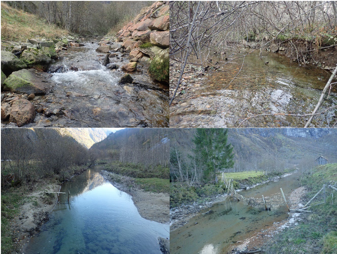
Figur 24. Myten vest for veien. Et langt parti er kanalisert og utrettet og mye silt har blitt liggende i elvebunnen. Basert på historiske flyfoto er bekken utvidet og kantvegetasjon er fjernet.
