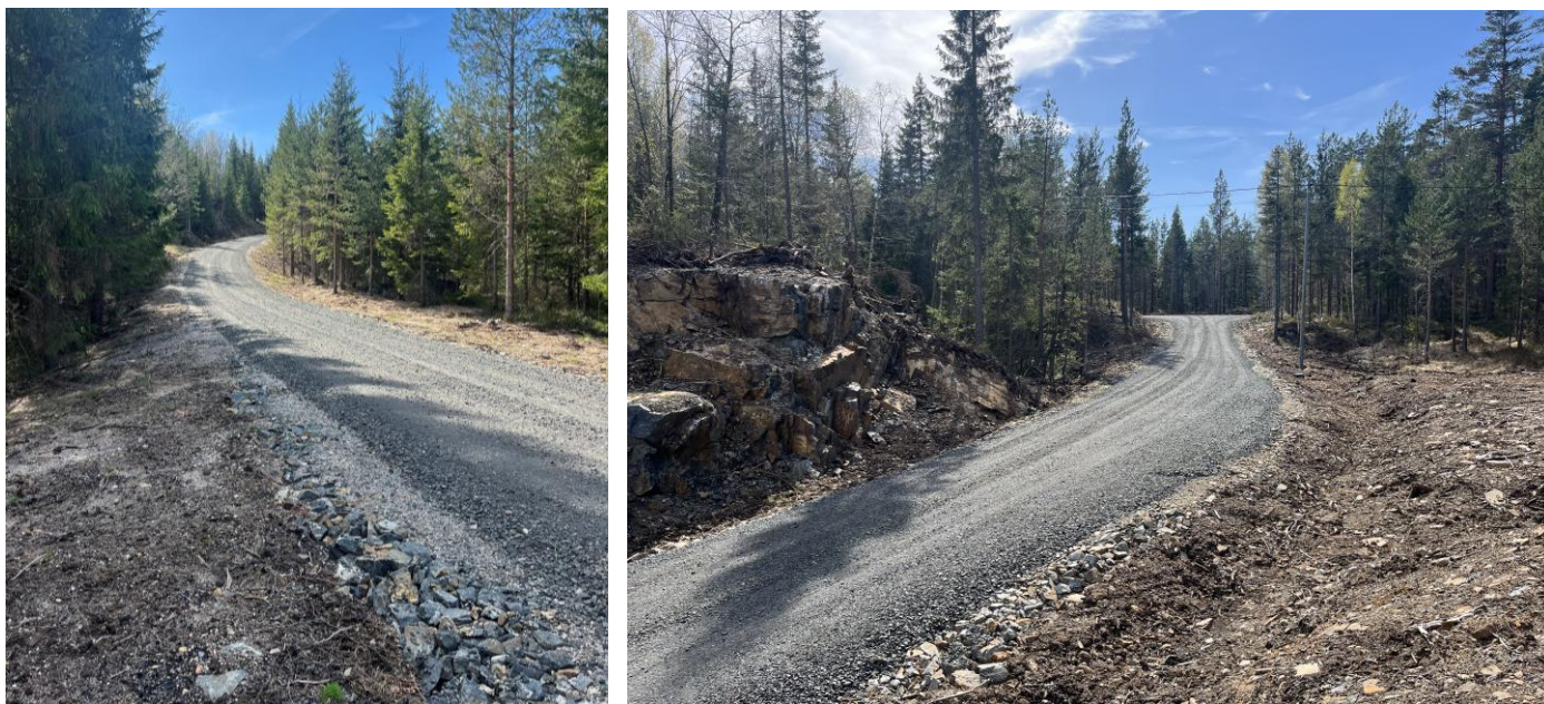
Ombygging (t.v.) og nybygging (t.h.) av skogsbilveier i Vegårshei i 2025, foto: Helge Sines
