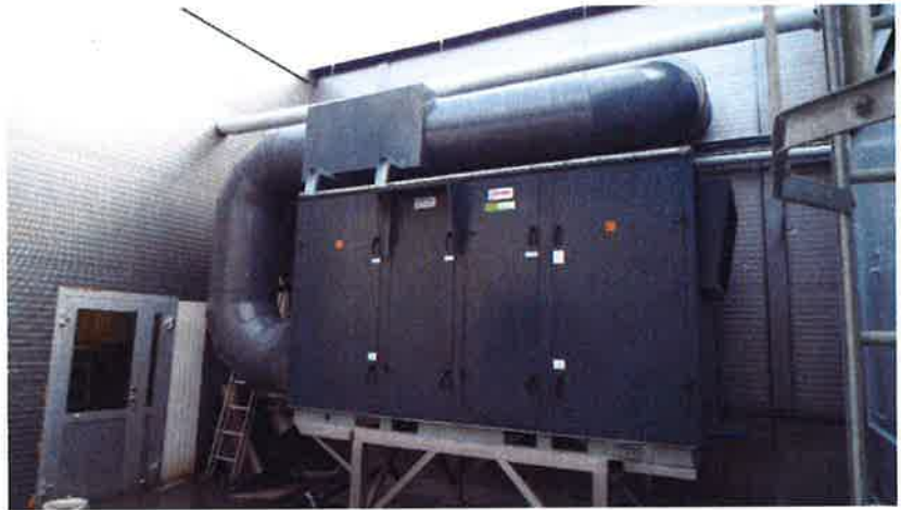
Figur 2: Vifte til produksjonshall
