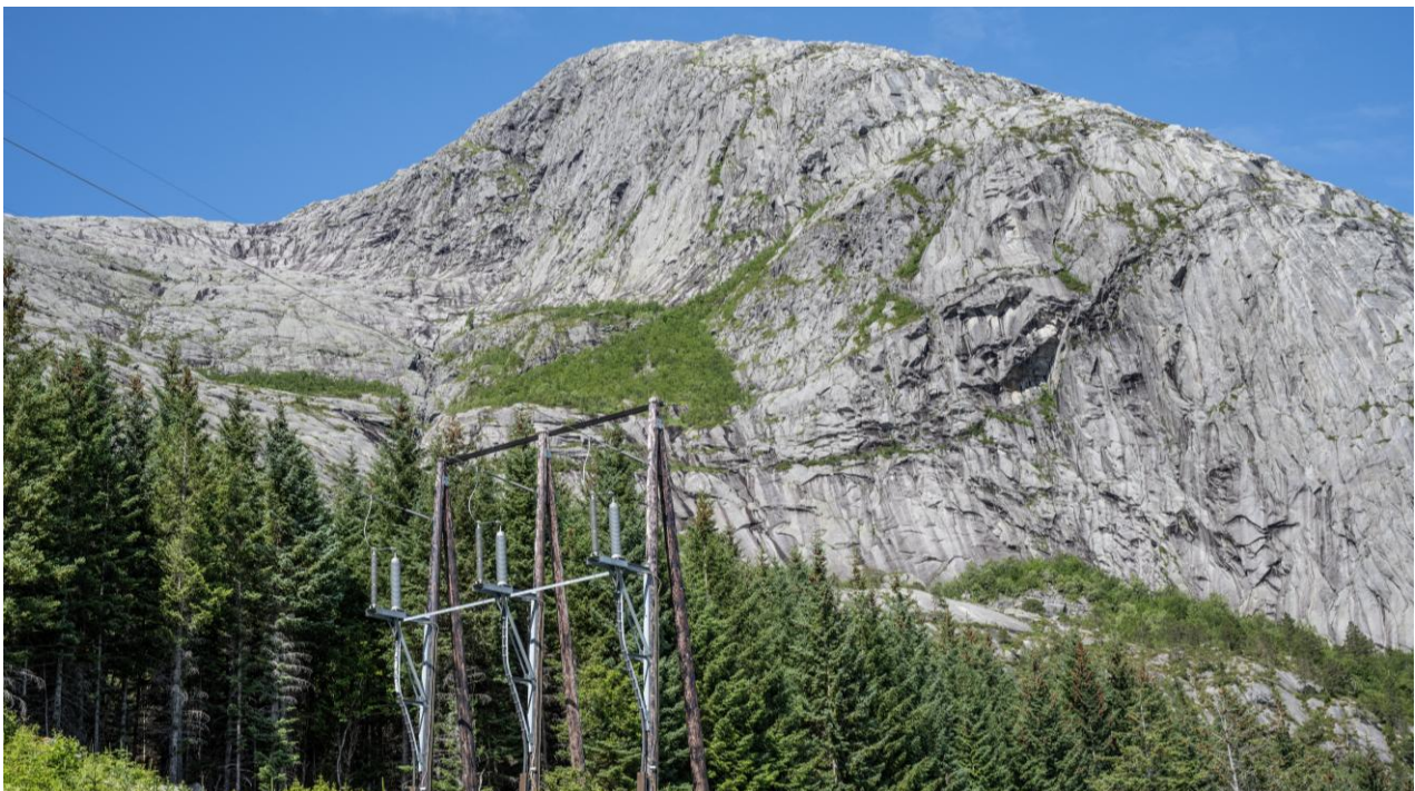
Figur 4: 132 kV regionalnett Grytåga - Alsten, Alstahaug. Fotograf: Stig Storheil, NVE.
