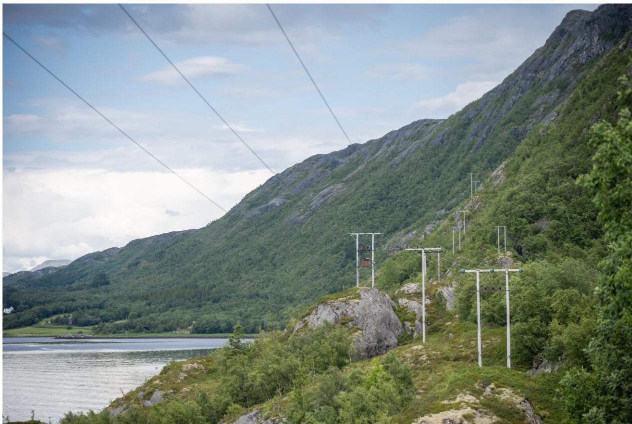
Figur 12: 11 kV distribusjonsnett, Finnvisa i Leirfjord kommune. Fotograf: Stig Storheil, NVE.
