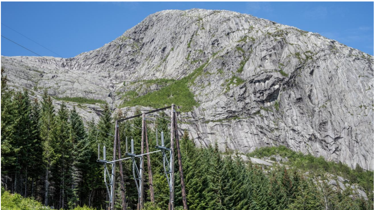
Figur 3: 132 kV regionalnett Grytåga - Alsten, Alstahaug. Fotograf: Stig Storheil, NVE
