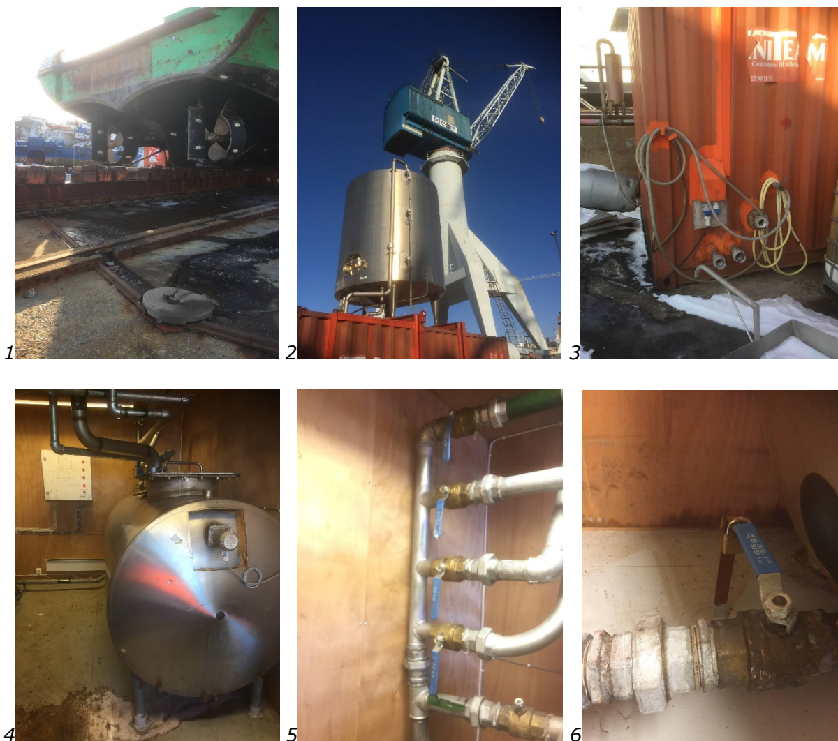
Figur 1, bilder av system for oppsamling og rensing av spylevann. Bilde 1 viser oppsamlingsrenne med kum. Bilde 2 viser tank som spylevannet pumpes opp i. Bilde 3 viser container med påkoblingspunkter for slange. Bilde 4 – 6 viser tank for oppsamling av avvirket materiale med tilhørende ventiler.
