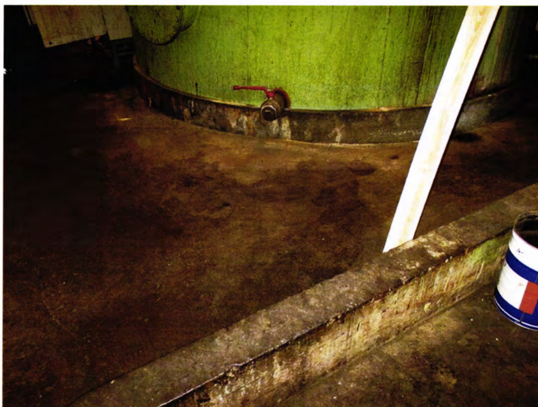
Figur 2.22: Også i gammel royallinje er prosessen og lagertanker i sin helhet omgitt av betongmur
