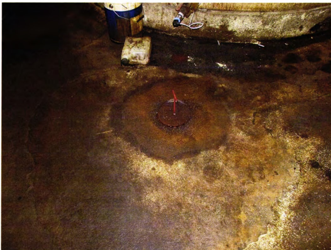
Figur 2.24: Sluk i gulv i gammel royallinje er tilknyttet oljeutskiller og utstyrt med lokk med gummibelegg på undersiden
