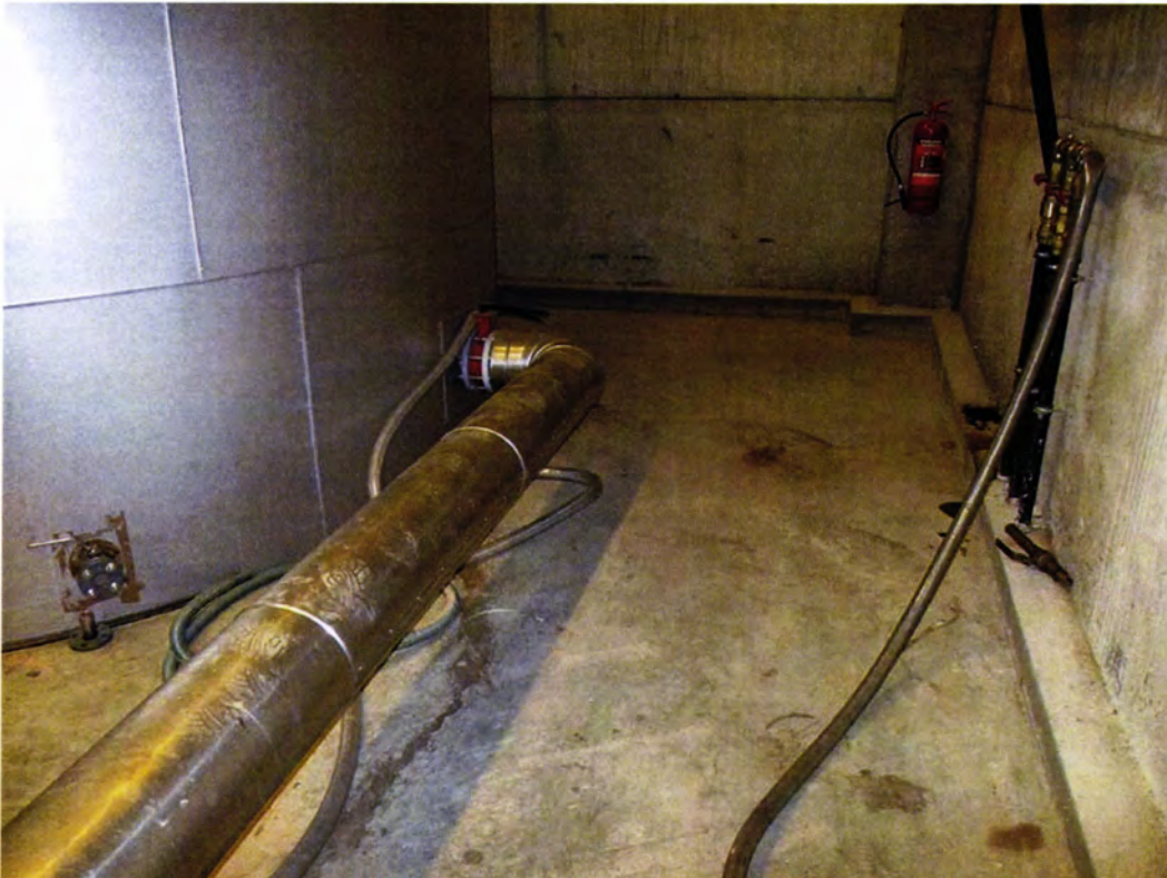
Figur 2.17: Ny royallinje inklusive lagertanker er i sin helhet plassert på tett betonggulv omgitt av betongkant med høyde ca. 15 cm
