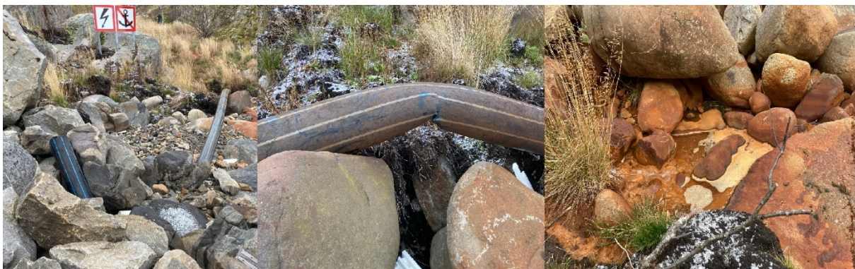
Figur 10: Avbildet er muligens sigevannsledningen uten synlig utslippspunkt, den er bøyd knekt i hvert fall på ett punkt. Flere områder i fjæra var tydelig påvirket av sigevannet.
