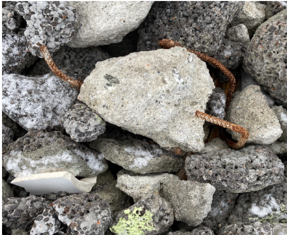
Figur 5: Det var en del armering og annet søppel iblandet lettlinkene og betongen
