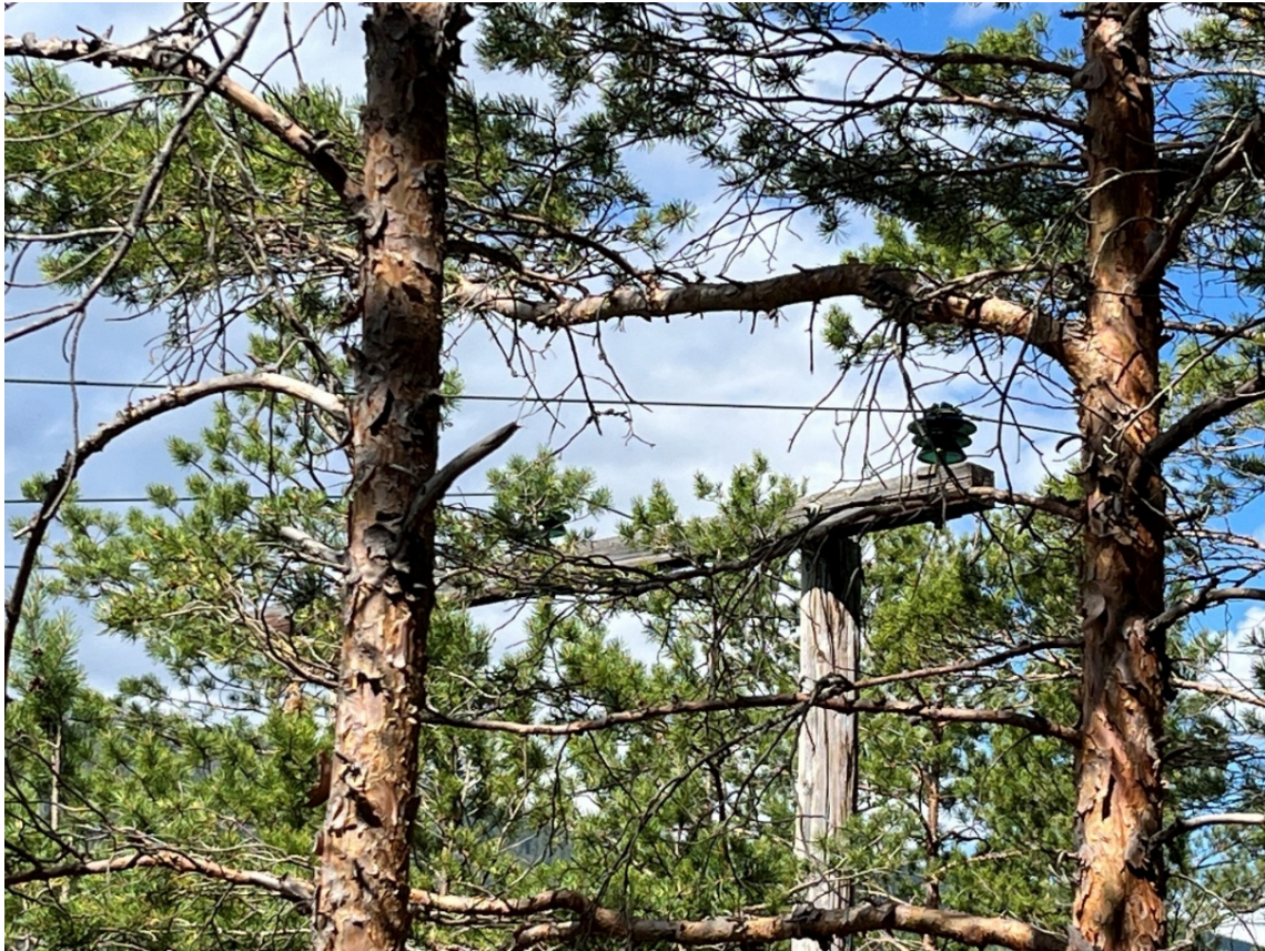
Figur 4 Den gamle 22 kV-linja har ikkje vore i bruk og er i dag attvokst med skog. Den bør fjernast før den fell ned, for å unngå å bli ein fare for folk og dyr. Foto: Statsforvaltaren i Vestland/ Maria Knagenhjelm.
