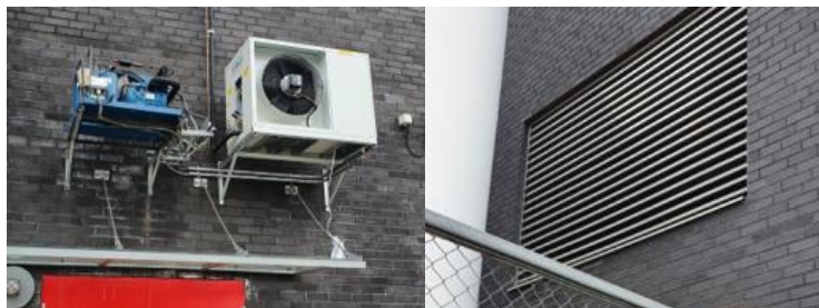
Figur 6: Henholdsvis vifte og avkast på vestsiden av anlegget (5)
