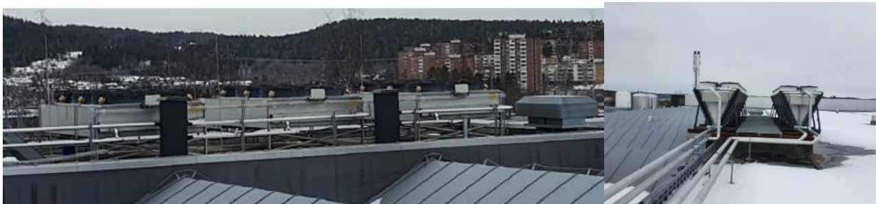
Figur 9: Plassering av tørrkjøler og avkast/vifter på tak
