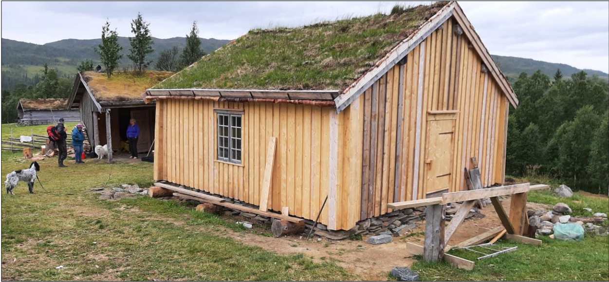
Istandsetting av seterstue fra 1870-tallet på Rømmervasseteren, Kvelia i Lierne kommune, Trøndelag. Finansiert av Kulturminnefondet og Utvalgte kulturlandskap, og gjennomført ved et omfattende dugnadsarbeid. Setra har et lite antall melkekyr og drives som besøksseter med servering av seterkost. Fra Kvelia utvalgte kulturlandskap. Foto: Ottar Bergli
