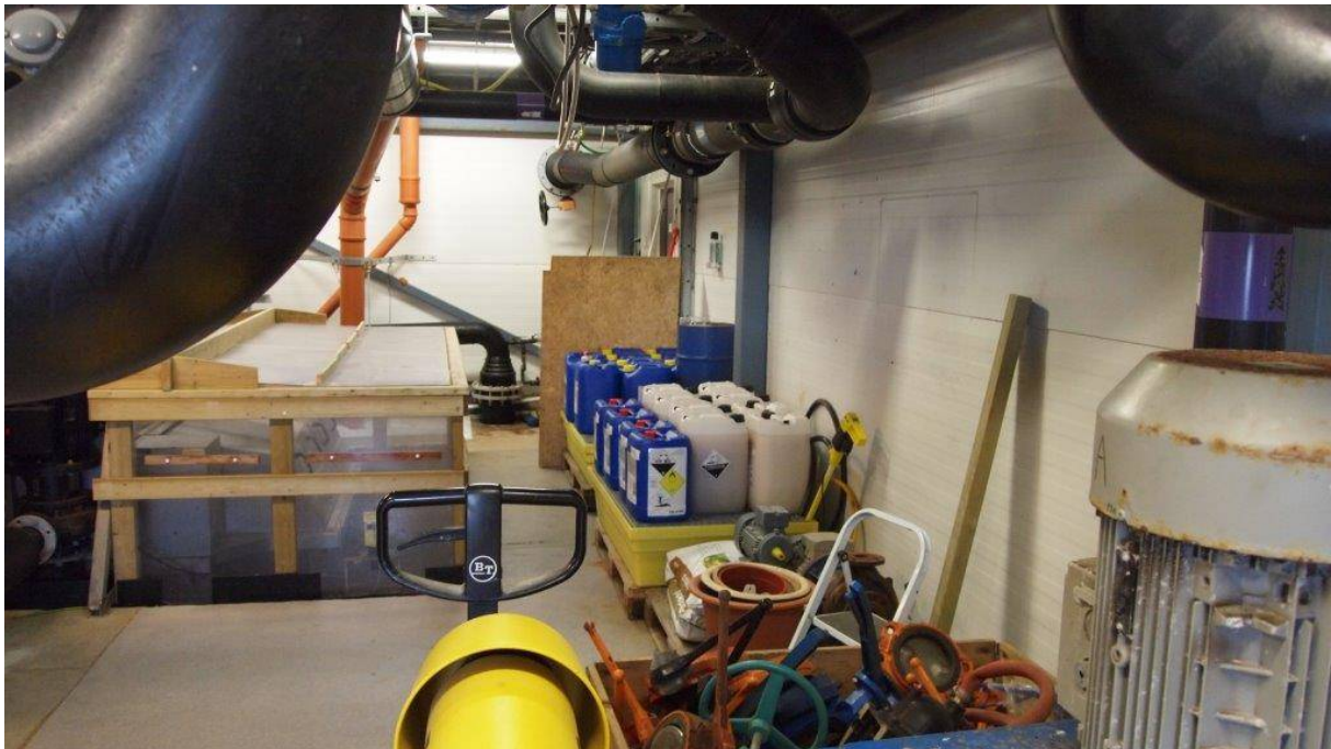
Figur 5. Oppbevaring av kjemikalier, der kanner er plassert så tett at reell mulighet for oppsamling ved eventuelt søl er minket.
