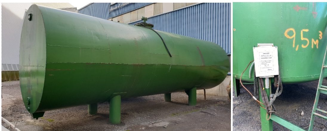
Figur 1: Venstre bilde viser lagertank for diesel, høyre bilde viser den største av to tanker for lagring av spillolje.
