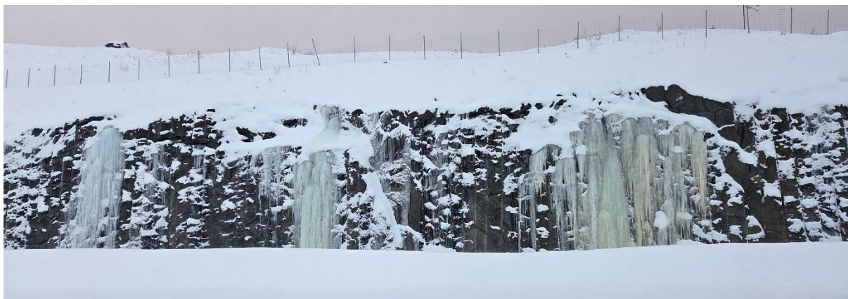
Figur 3 Bilde tatt under befaring av planområdet 07.01.2026 som viser vannutslag fra bergskjæringen sørøst i planområdet.
