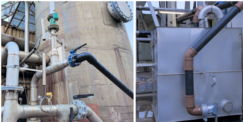
Scrubber med flow-måler (venstre) og kullfilter på lagertanker (høyre)
