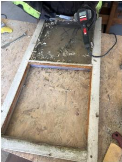
Måling og kittresten vart fjerna.
